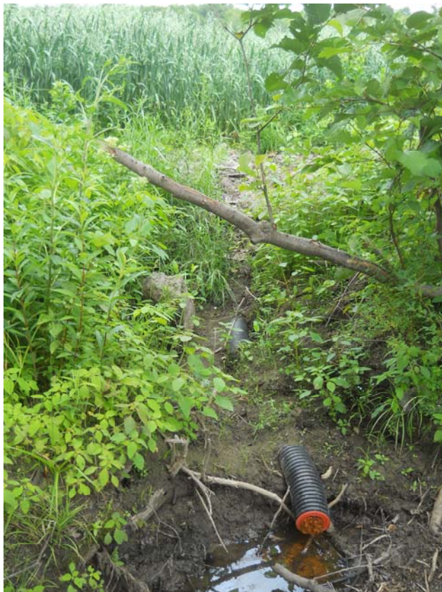
Figure 8 Sortie de drain et ravinement
